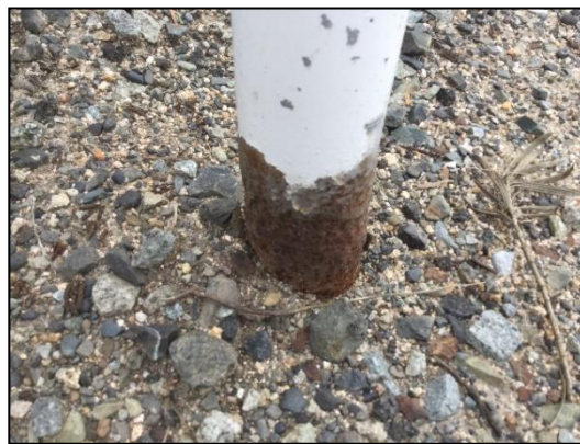
標識柱地際部分の腐食
