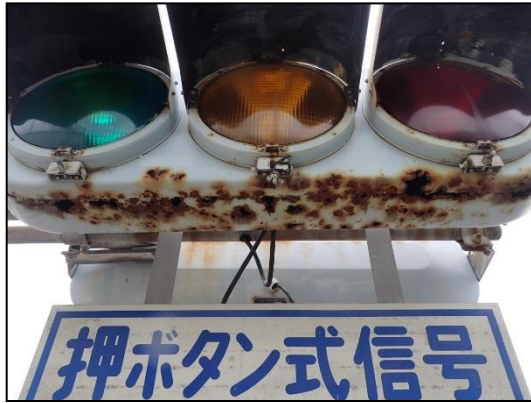
信号灯器の腐食
